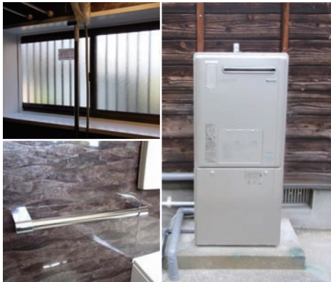
高効率ガス給湯器(右)・窓の断熱(左上)・バリアフリー(左下)
